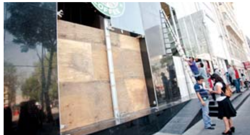
DAÑOS. En avenida Juárez reparan destrozos; el GDF apoyará a hoteles afectados
